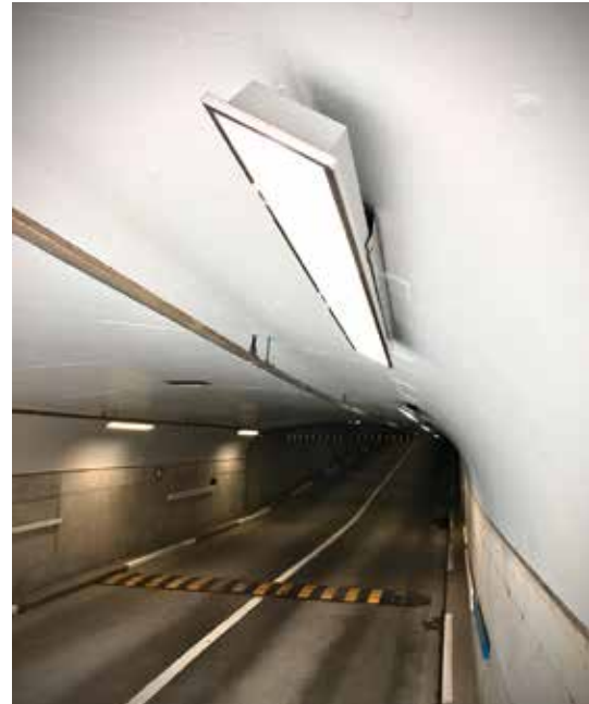
Beleuchtungsanierung im Parkhaus Sils i. Engadin: die Ein- und Ausfahrt wird mit PLANK beleuchtet, denn sie überzeugt als robuste, zuverlässige und funktionale Leuchte.
