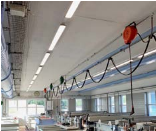
Anox AG, impianto galvanico, Affoltern am Albis Sostituzione del vecchio impianto di illuminazione FL con le lampade industriali PLANK sul sistema a binari TURBO.
