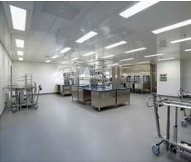
Ospedale Spital Muri AG Ristrutturazione con una soluzione personalizzata con lampade per camera bianca dotate di vetro struttura multistrato.
